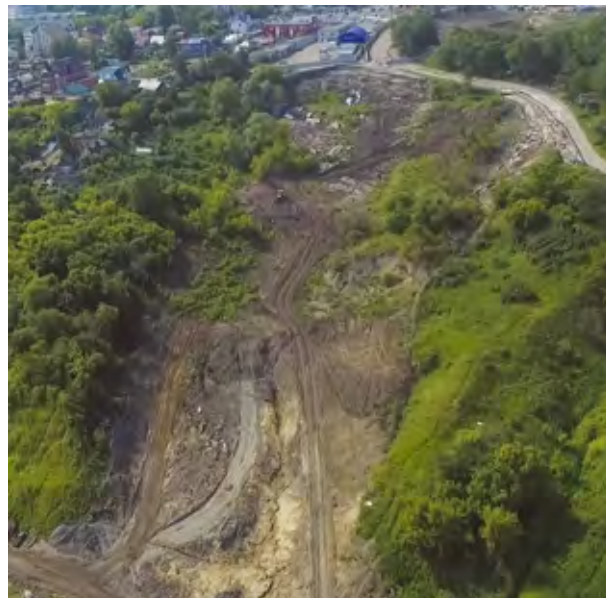
Рис. 2. Общий вид оползня. Прокладывание дорог для новых инженерно-геологических изысканий. 19.06.2016 г.
