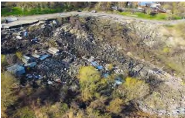
Рис. 1. Верхняя часть оползня. 27.04.2016 г.
