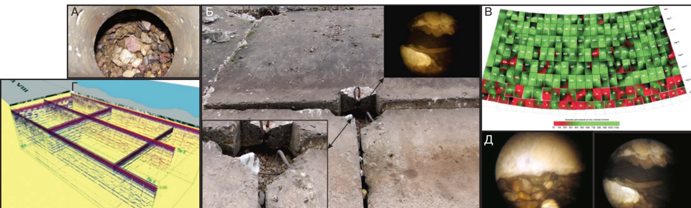
Рис. 1. Береговой откос (БО) на Нижнекамской ГЭС: А – нарушение контакта монолитных плит крепления БО с основанием (обратным фильтром – ОФ); Б – нарушение контакта сборных плит крепления БО с основанием (ОФ); В – результаты виброакустических исследований плит БО в виде карт распределения центральной частоты спектра сигнала; красным цветом выделены участки нарушения контакта; Г – трехмерное представление результатов георадиолокационных исследований плит крепления и основания под ними; Д – изображения, полученные с помощью технических эндоскопов
