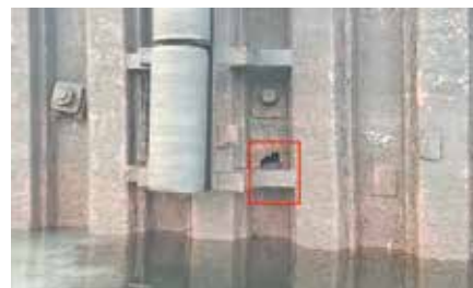
Рис. 2. Сквозная коррозия шпунта причала № 8
