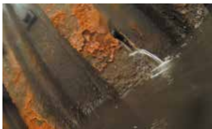
Рис. 1. Сквозная коррозия шпунта причала № 7
